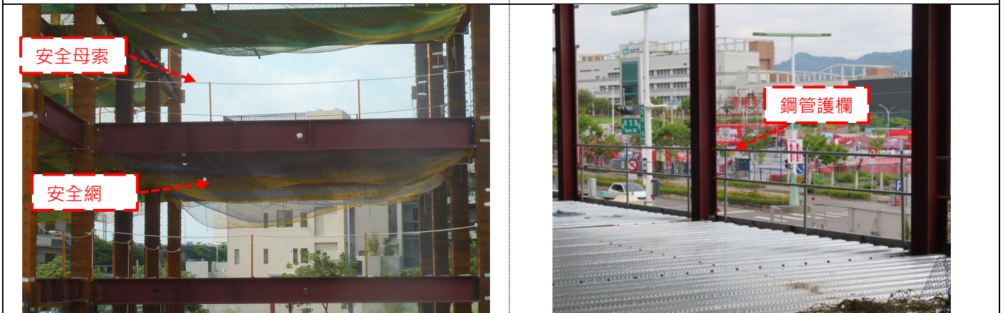
鋼構安裝設置護欄有困難時，應設置安全網及供鈎掛安全帶之安全母索；樓板鋼承鈎鋪設完成後應即時於開口部分設置鋼管護欄。
