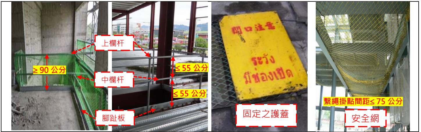
高度 2 公尺以上之開口部分應設置護欄(具上欄杆、中欄杆及腳趾板)、護蓋或安全網
