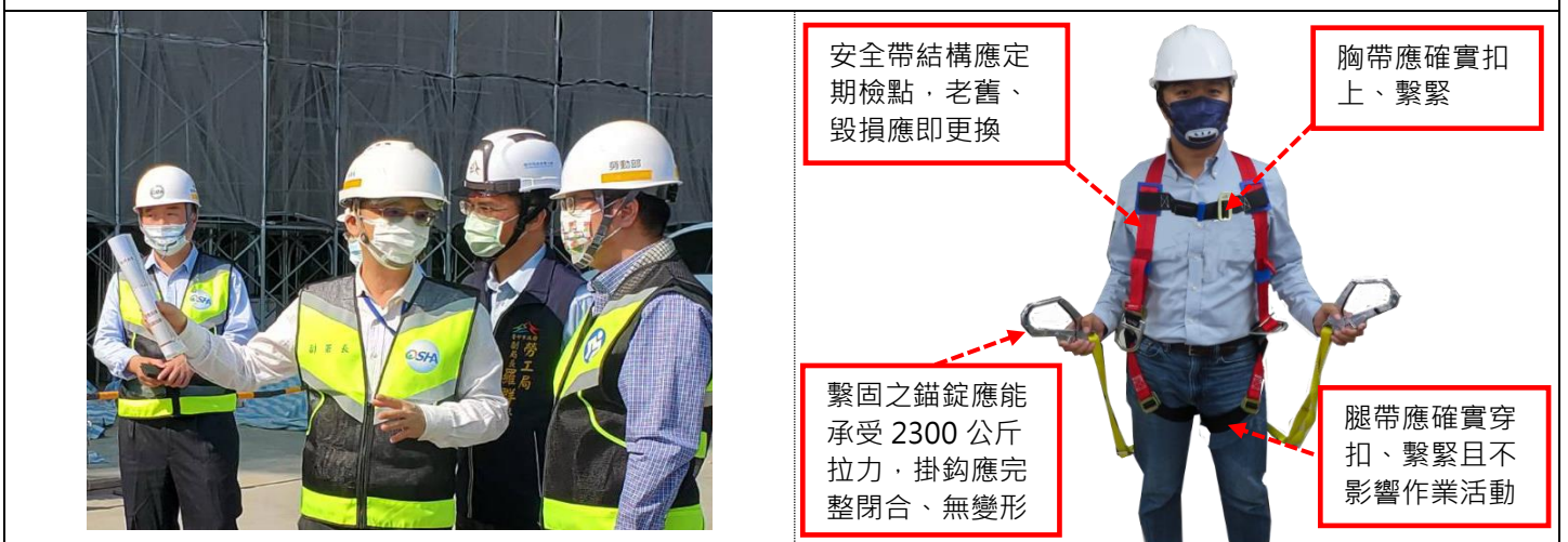
進入工地人員應正確戴用安全帽，並確實繫上頭帶(帽扣)；高架作業人員應使用安全帶。
