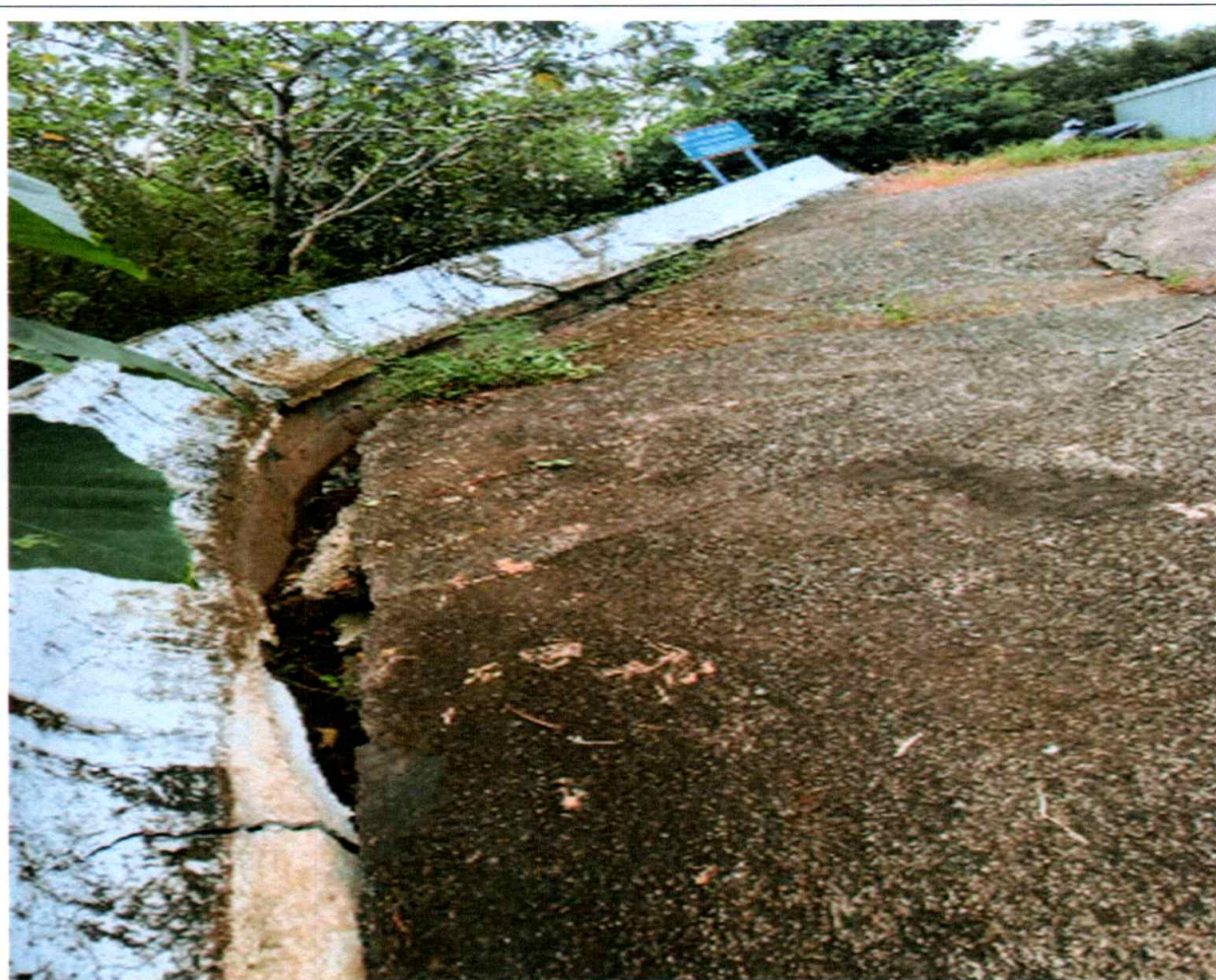
屏東縣獅子鄉中心崙公墓災害受損照片
