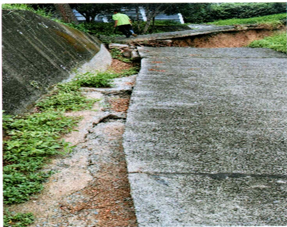
屏東縣獅子鄉中心崙公墓災害受損照片
