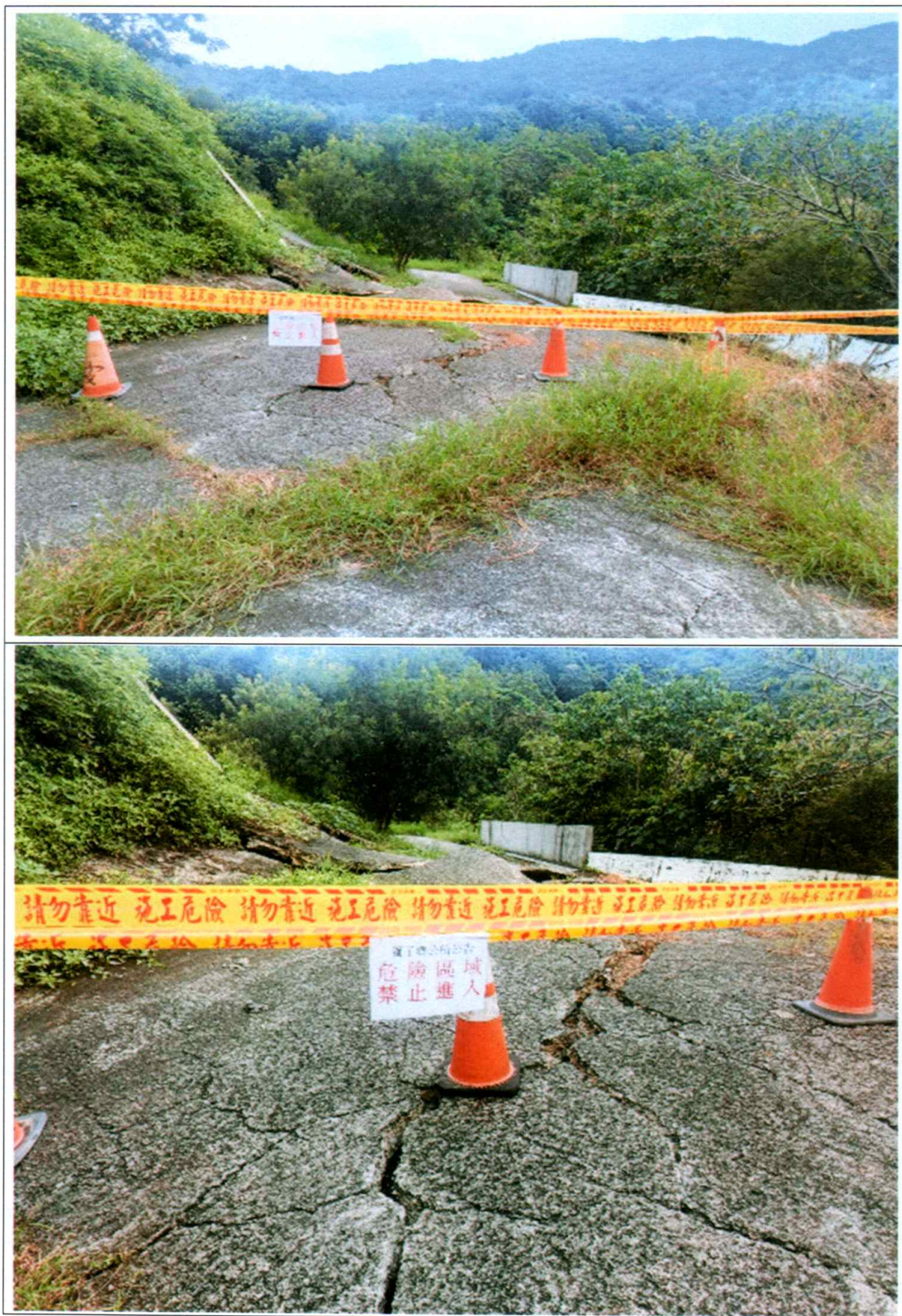
屏東縣獅子鄉中心崙公墓災害受損照片
